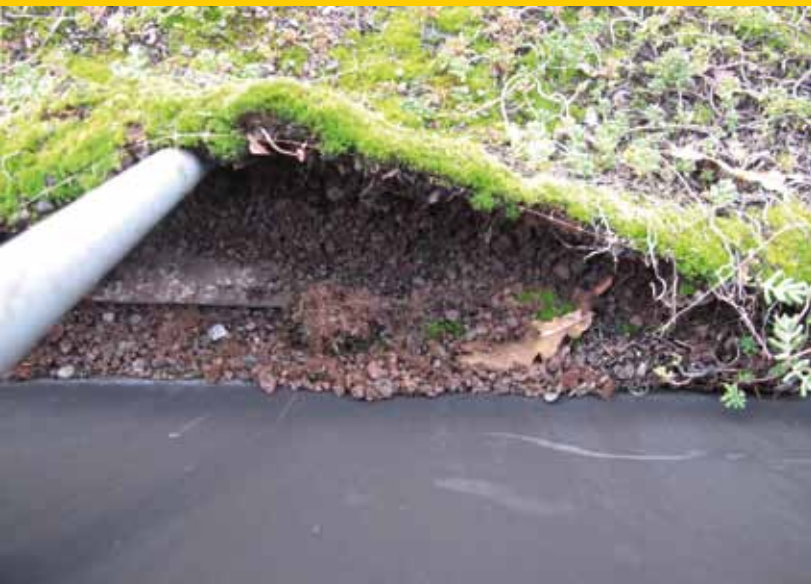
Verkeerde dakopbouw; recycled doek en dunne substraatlaag houden vocht vast met als gevolg sterke mosvorming en overdreven onderhoud.
