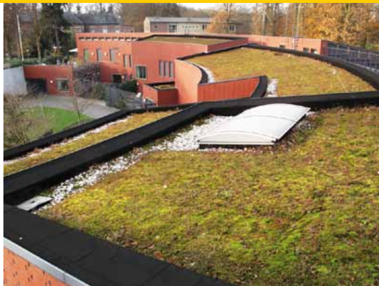
Geen onderhoud geeft verarming van de sedumgroei; door de verkeerde laagopbouw vindt tegelijkertijd verrijking van mossen plaats.
